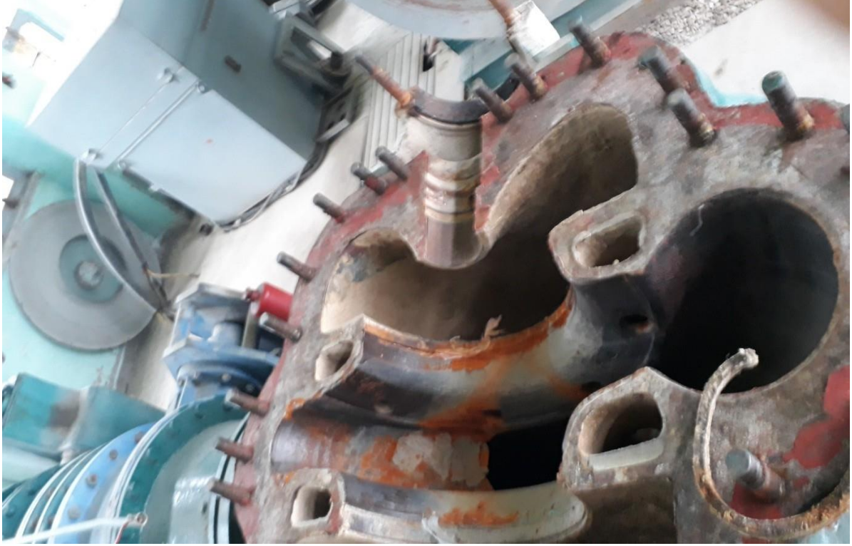
P2 Pompa İstasyonu Motorların içerden görüntüsü
